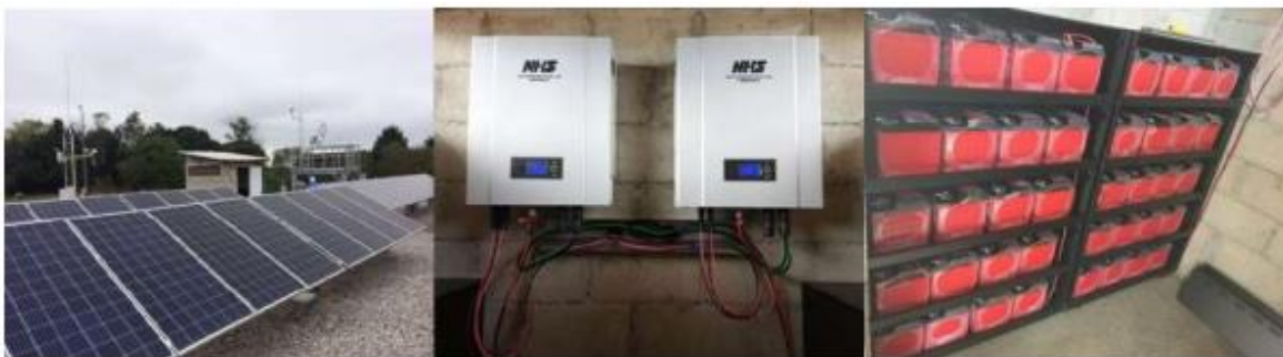
Figura 4. Sistema fotovoltaico com baterias instalado da UTFPR
