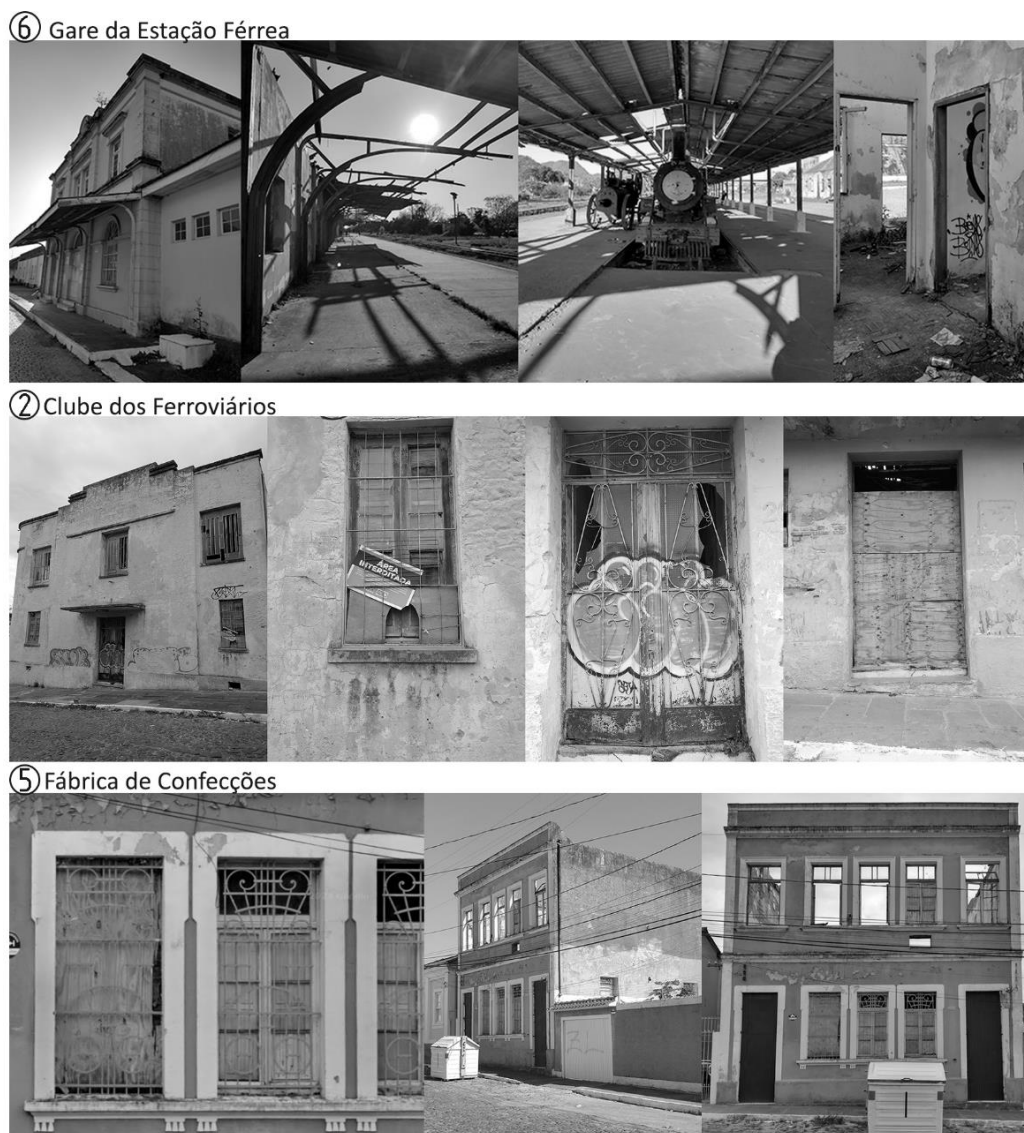
Figura 22: Edifícios em situação de abandono.
