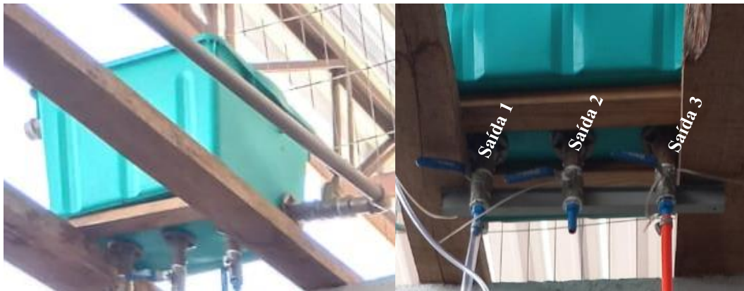
Figura 25 - Reservatório superior de água bruta (tanque de amortecimento).
