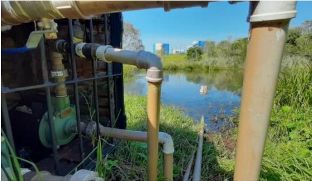
Figura 23 - Sistema de captação de água bruta.
