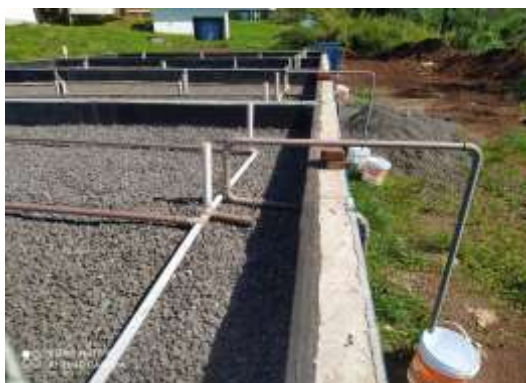
Figura 16: Medição da vazão de entrada do esgoto.
