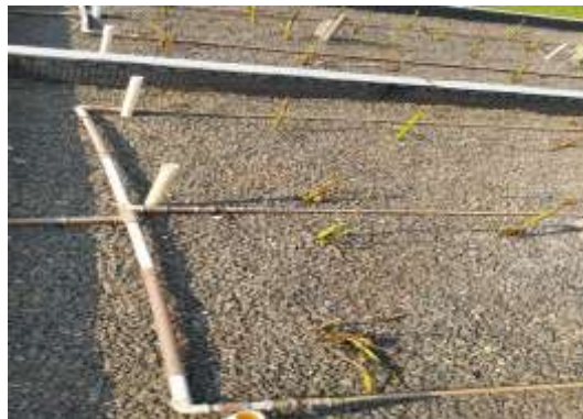
Figura 19: Tubulação de distribuição de 20mm.
