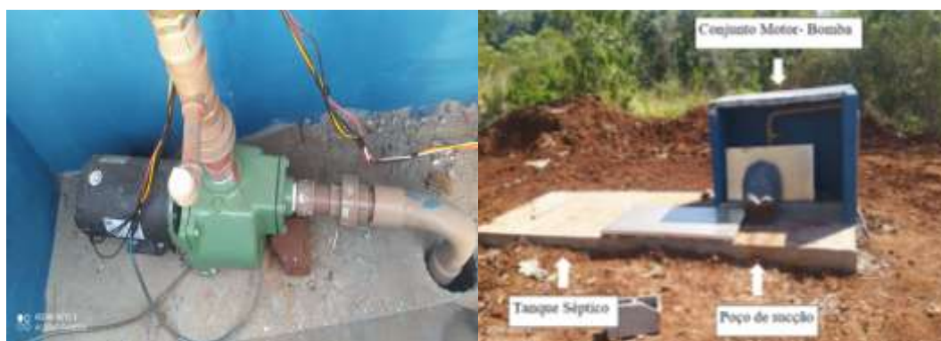
Figura 13: Bomba de recalque, tanque séptico e poço de sucção.
