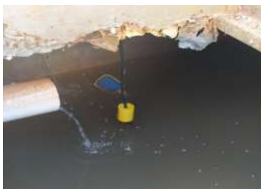
Figura 15: Boia que controla o acionamento da bomba que realiza o recalque do esgoto para os WCFV.
