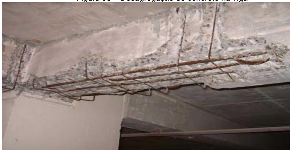
Figura 08 – Desagregação do concreto na viga
