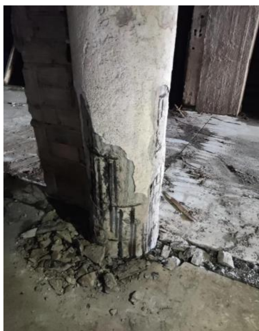
Figura 32 – Pilar com armadura exposta
