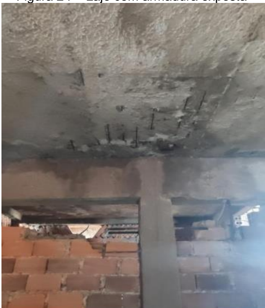
Figura 24 – Laje com armadura exposta
