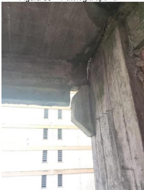
Figura 35 – Patologia tipo “d”
