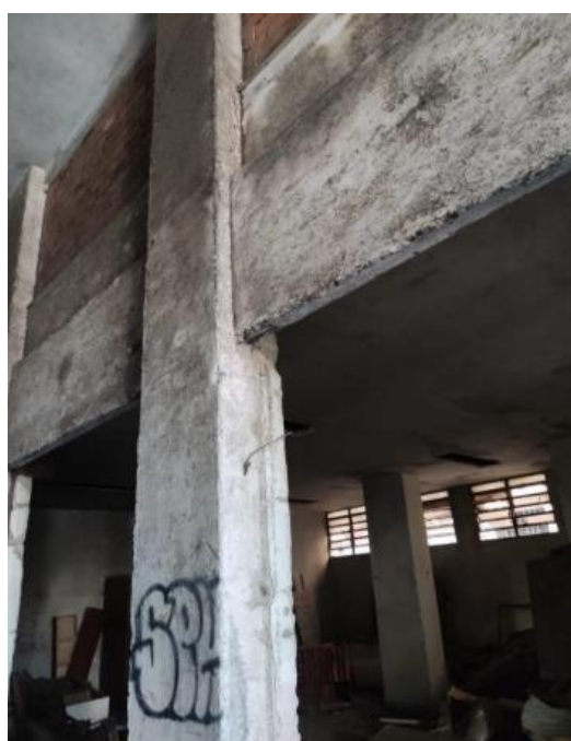
Figura 29 – Viga com armadura exposta
