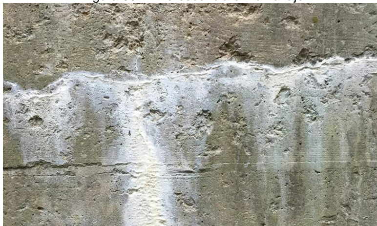
Figura 09 – Eflorescência em uma laje
