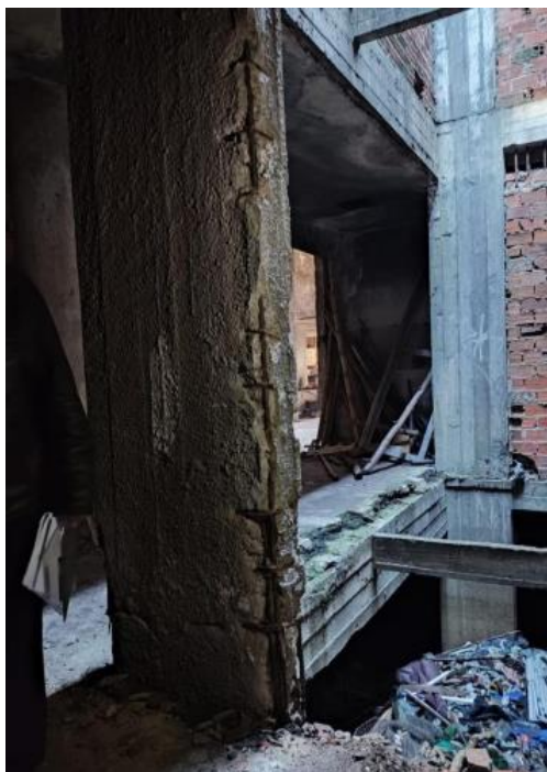
Figura 33 – Pilar com armadura exposta
