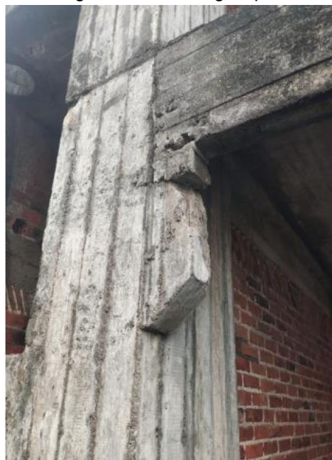
Figura 36 – Patologia tipo “d”
