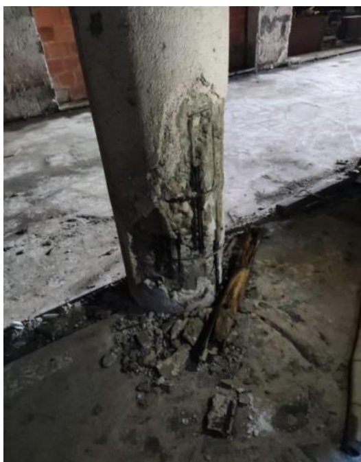
Figura 31 – Pilar com armadura exposta
