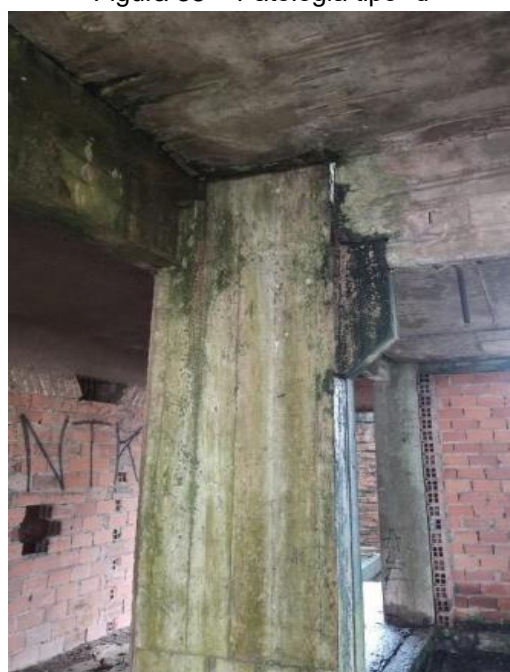
Figura 38 – Patologia tipo “d”
