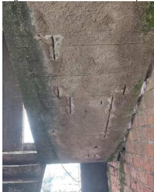
Figura 27 – Escada com armadura exposta
