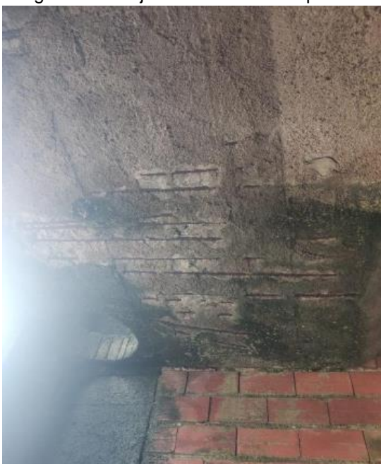
Figura 26 – Laje com armadura exposta
