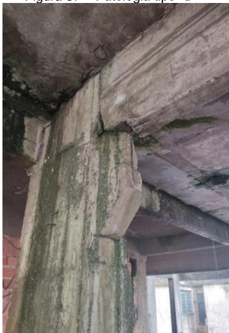
Figura 37 – Patologia tipo “d”
