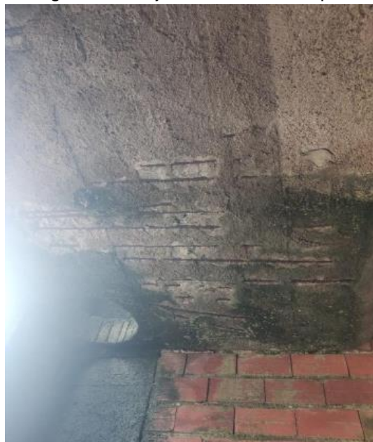
Figura 25 – Laje com armadura exposta
