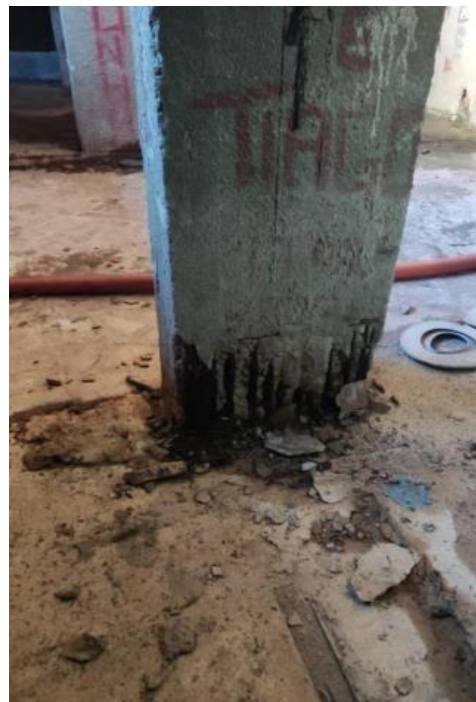
Figura 34 – Pilar com armadura exposta
