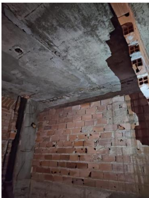
Figura 28 – Viga com armadura exposta
