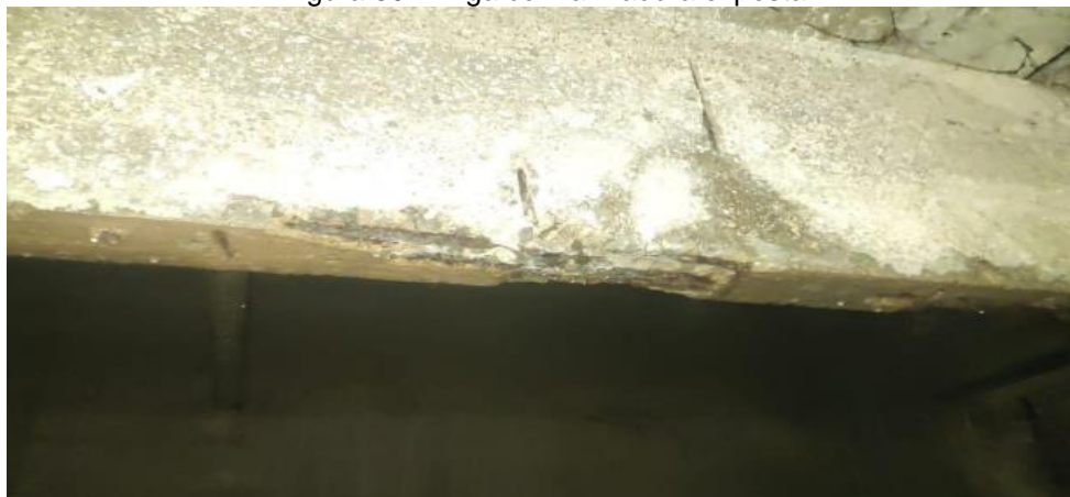
Figura 30 – Viga com armadura exposta
