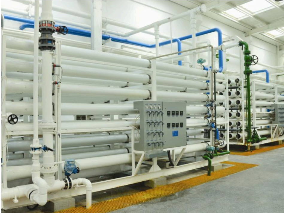
Figura 27 - Equipamento de filtro de membranas
