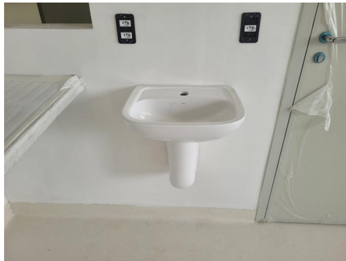
Figura 12 - Lavatório na sala de manipulação
