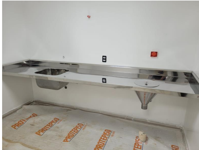
Figura 22 - Bancada da sala de utilidades
