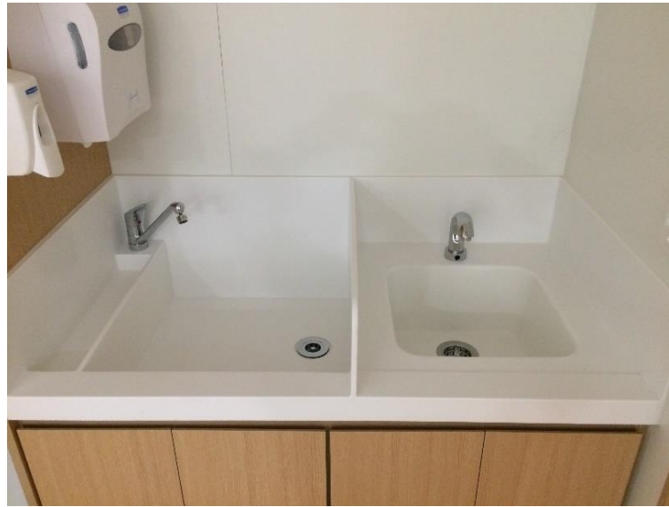
Figura 3 - Pia de lavagem à esquerda e lavatório à direita
