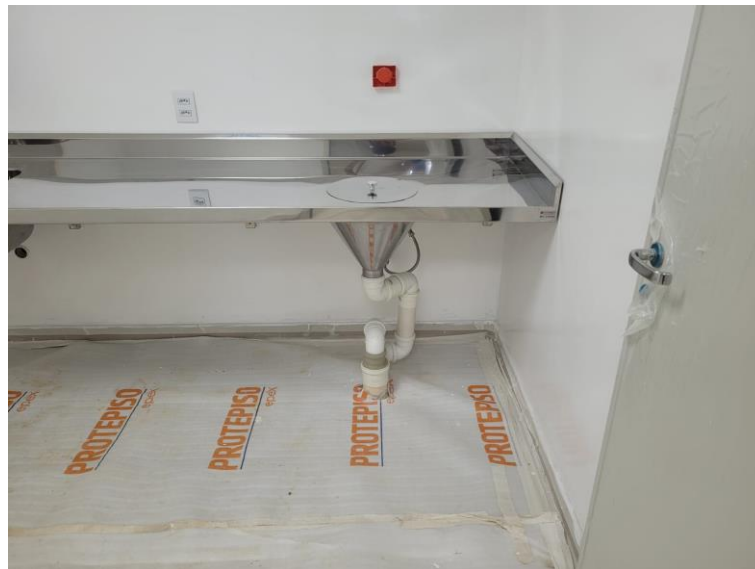
Figura 23 - Área de expurgo com válvula e tubulação de 75 mm
