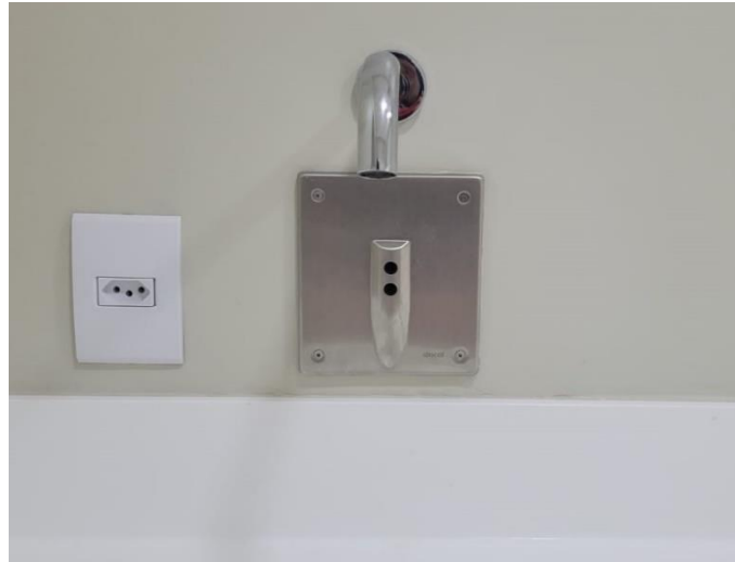
Figura 18 - Torneira ativada por sensor
