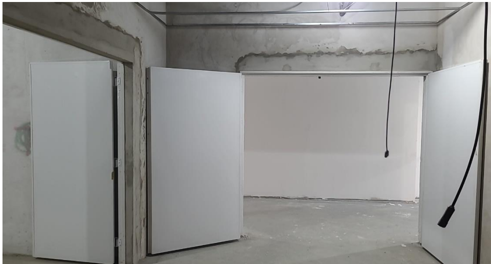
Figura 57 - Porta corta-fogo antecâmara e escadas
