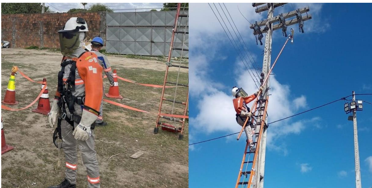
Figura 4 – A esquerda um trabalhador utilizando todos os EPIs necessários antes de manobrar circuito elétrico. A esquerda o mesmo trabalhador abrindo chaves seccionadoras de circuito.
