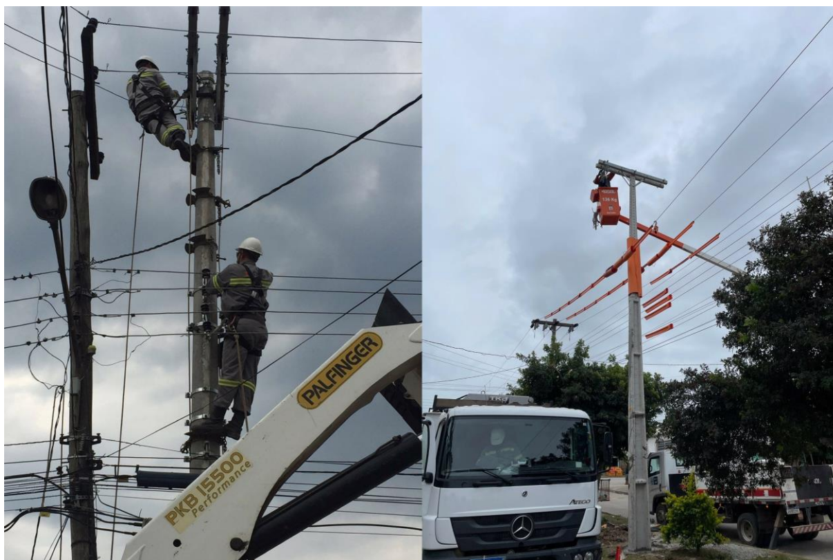
Figura 1 – Trabalhadores executando atividades em Linha Morta (a esquerda). Atividade de Linha Viva (a direita)
