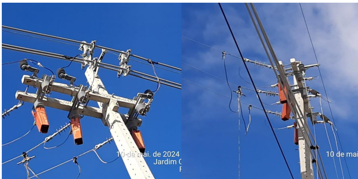
Figura 3 – À esquerda é mostrado os invólucros de chaves, que são utilizados para bloqueio do circuito. A direita é possível visualizar os aterramentos temporários de média tensão.
