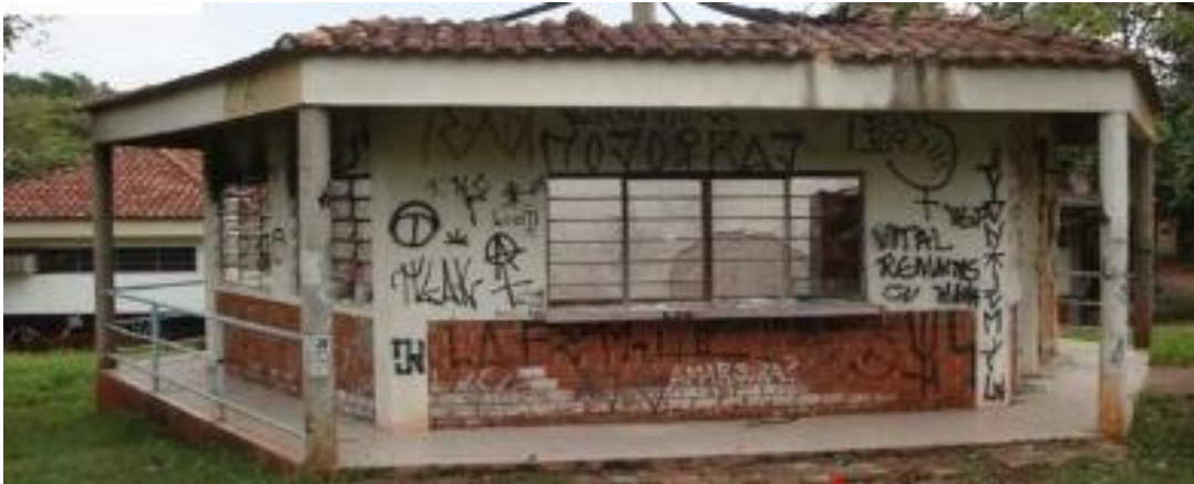
Figura 9 - Aspecto geral da Edificação após o Incêndio
