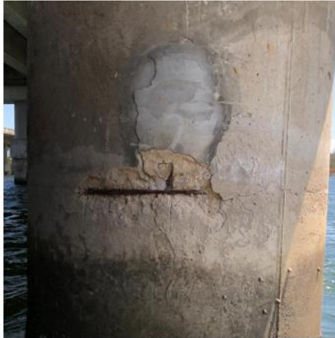
Figura 34 - Observação e identificação das anomalias, e corrosão visível do aço
