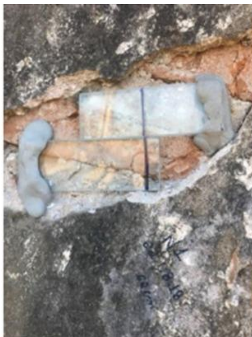
Figura 13 - Controle de Fissuras na janela de Inspeção
