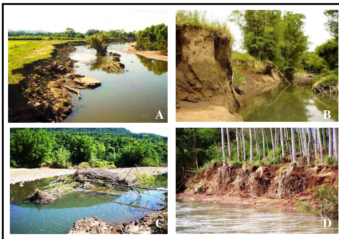
Figura 2 – Problemas comuns em cursos de água: A, B – corrosão das margens; C – touceiras de taquara caídas sobre o leito; ; D – árvores de grande porte sobre o talude (Fotos: Fabrício Jaques Sutilli).
