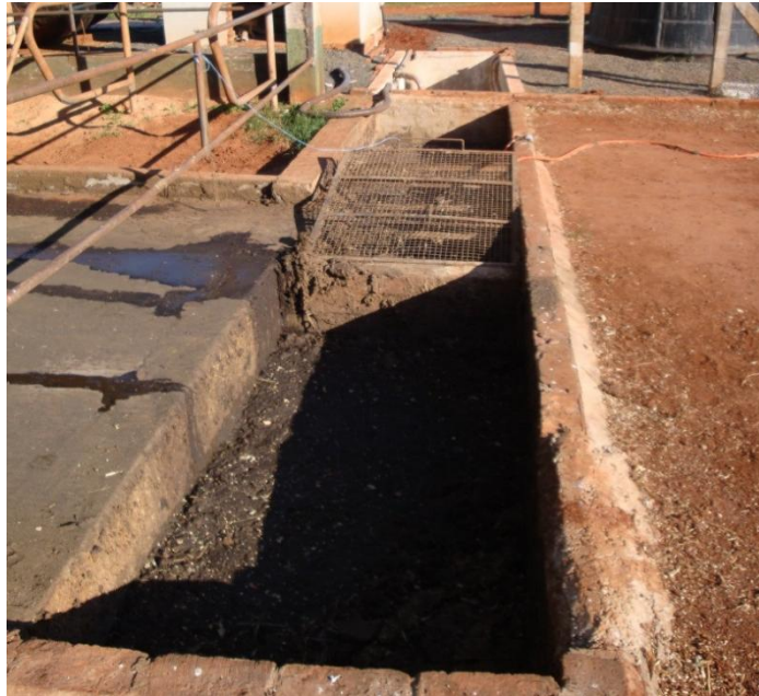
Figura 20 – Tanque de captação e homogeneização dos resíduos
