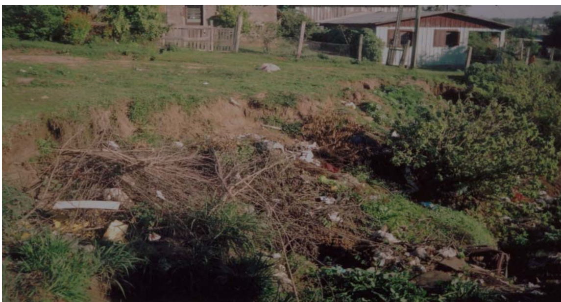
Figura 12 – Limite da residência e/ou limite da voçoroca. Fonte: Trabalho de campo realizado em setembro de 2004.
