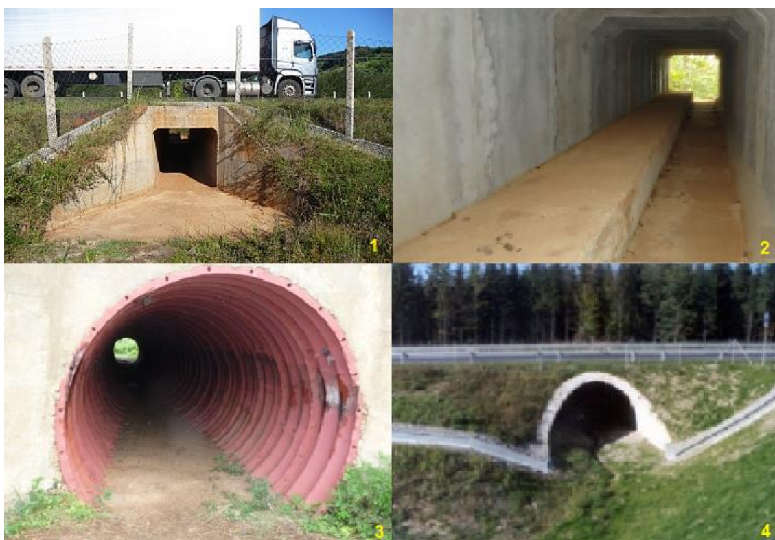
Figura 8 - Bueiros modificados para favorecimento da passagem de fauna. 1 e 2) Tubo celular com plataforma para a passagem de fauna terrestre; 3) Bueiro circular de aço corrugado com substrato de terra e 4) Bueiro em arco com plataforma para passagem de fauna terrestre.
