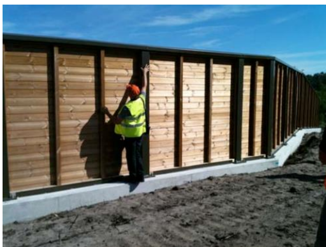
Figura 3 - Barreira antirruído funcionando, também, como direcionadora de fauna na França meridional.
