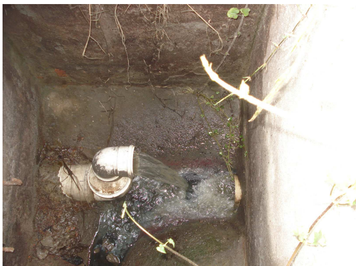
Figura 5. Local de coleta do efluente utilizado nos experimentos com diclofenaco. Fossa séptica localizada na ala sul do PA-HUSM.
