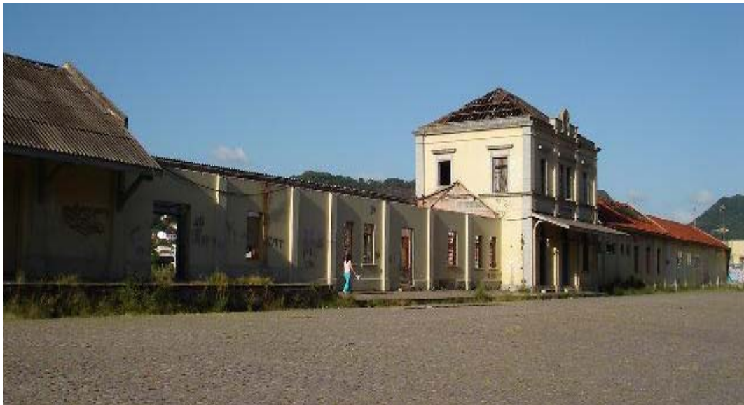
Figura 6 - Parte da Estação Ferroviária, danificada por vandalismo e incêndio, após privatização. Fonte: Arquivo Pessoal (2004).
