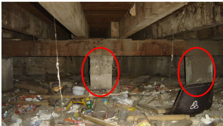
Figura 41 – Pilaretes de sustentação da estrutura do piso na metade esquerda do prédio. FONTE: a autora, 2011.
