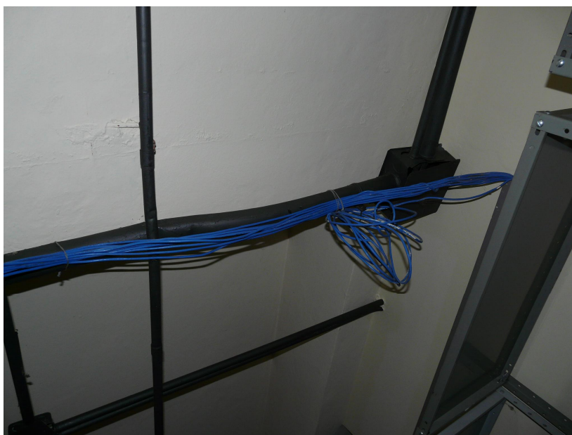
Figura 2 . Dutos da rede elétrica e fiação de internet. (Foto Carlos Blaya).
