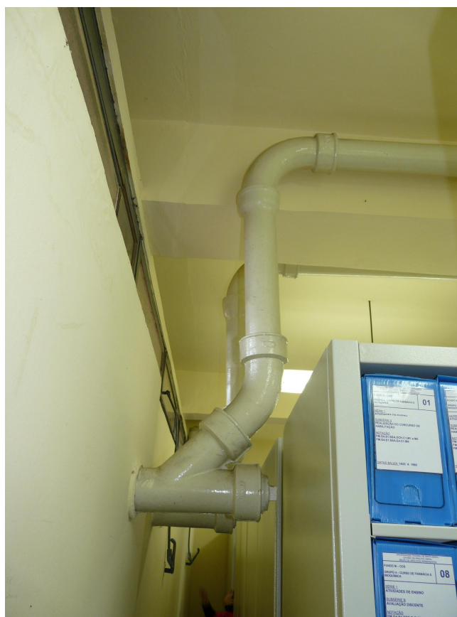
Figura 3 . Canos hidráulicos da rede de esgoto. (Foto Carlos Blaya).
