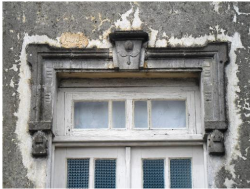
Figura 76: Detalhe esquadria com verga reta e cercaduras decorativas na parte superior. Fonte: A autora, 2012.
