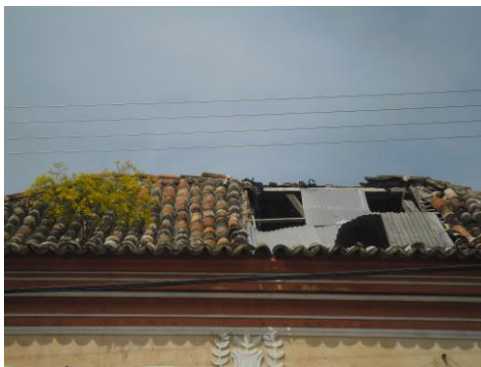
Figura 17: Detalhe telhado danificado e com vegetação daninha. Fonte: A autora, 2012.
