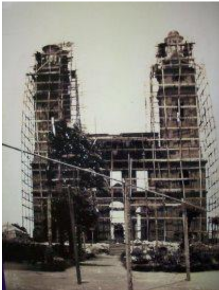
Figura 31: Fachada frontal, em construção. Fonte: acervo de Gelson Nunes de Oliveira, s/d.
