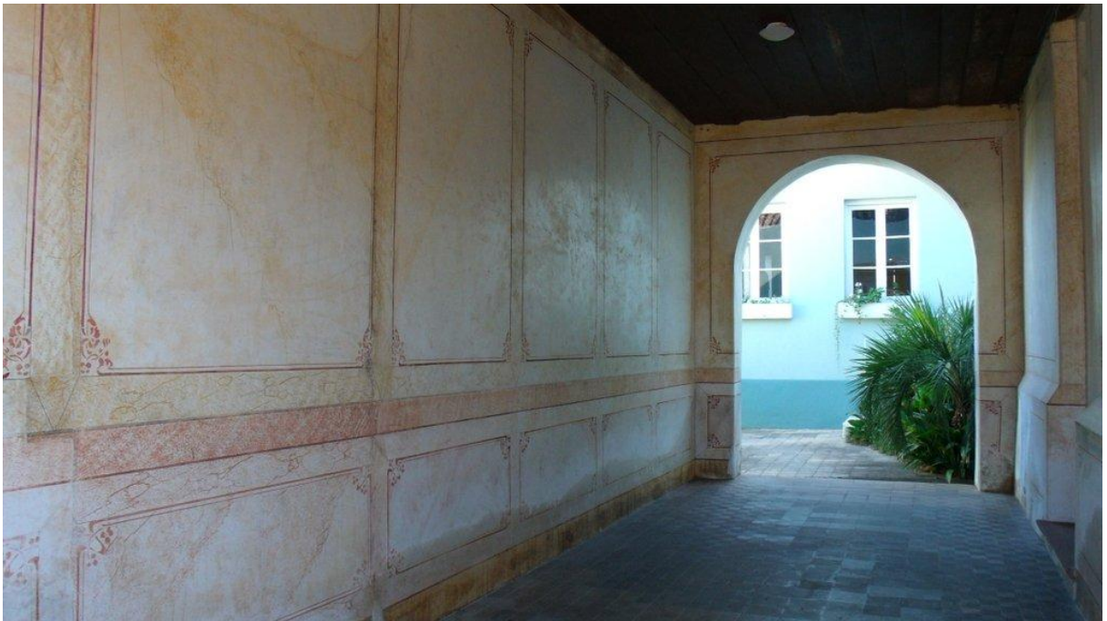
Figura 16 – Casa da Família de José Chiappetta – Presença de paredes em escaiola. Fonte: Daniele Moreira.
