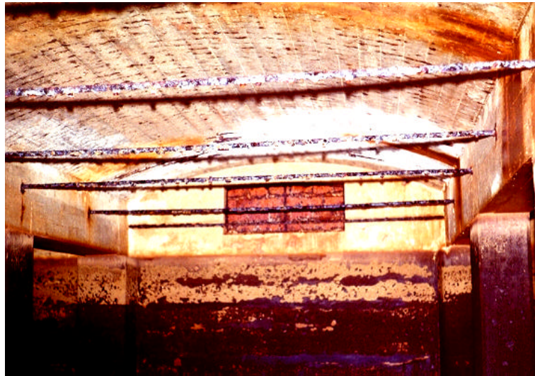
FIGURA 19 – Oxidação da armadura das cascas e tirantes.
