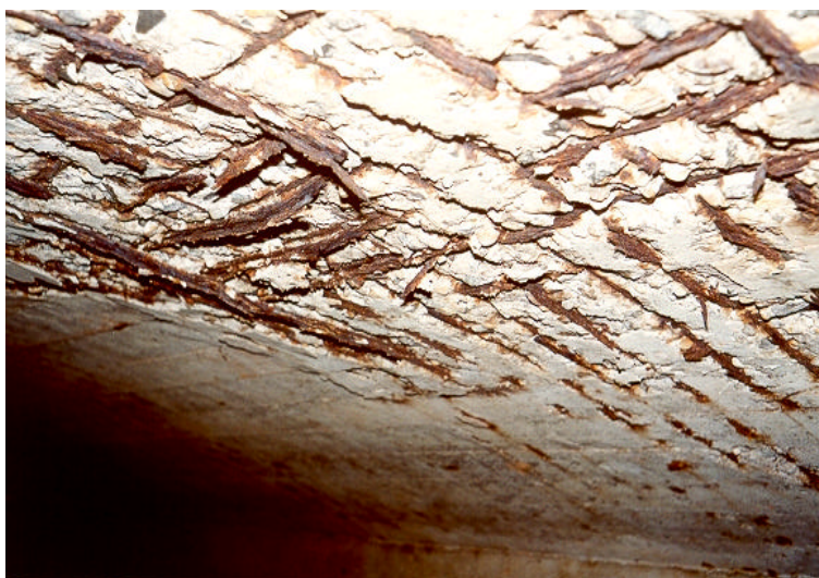
FIGURA 22 – Oxidação da armadura e deslocamento.
