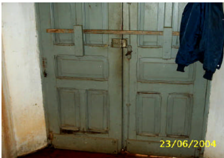
FIGURA 33 – Portas de madeira mal conservadas.
