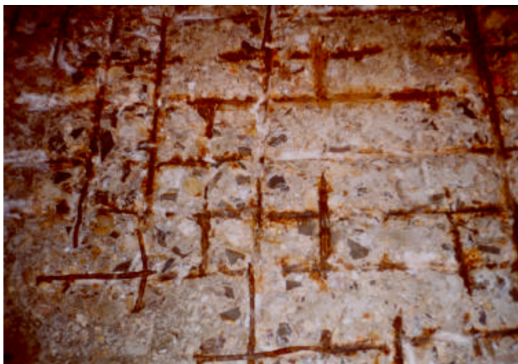
FIGURA 26 – Vista da superfície após remoção da parcela frágil.
