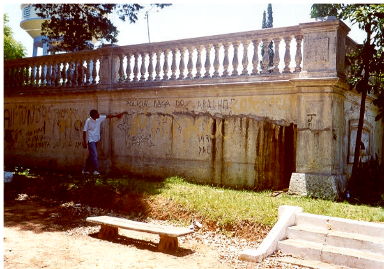
FIGURA 20 – Fissura nas paredes externas, apoio das cascas.
