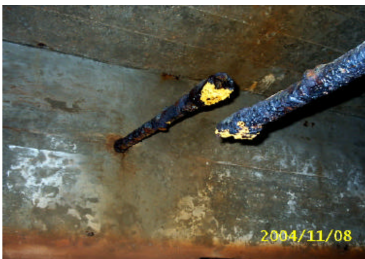
FIGURA 23 – Oxidação e rompimento dos tirantes.
