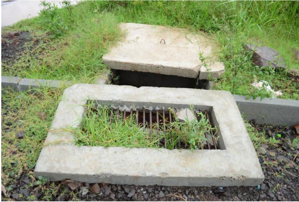
Figura 6- Material com rachaduras Fonte: Revista O Viés
