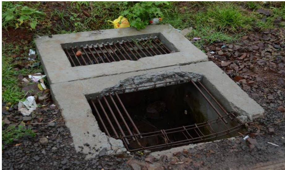
Figura 5- Material deteriorado. Fonte: Revista O Viés
