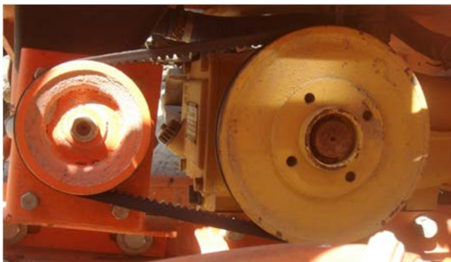
Figura 27: Ausência de proteção de correia e polia. Fonte: Martini, 2015.
