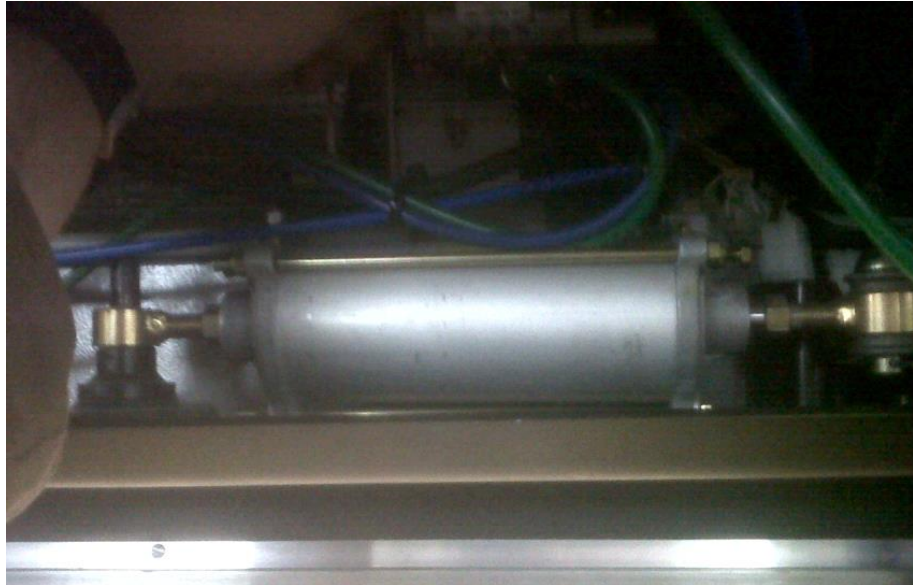
Figura 14- Mangueiras com comprimento excessivo
