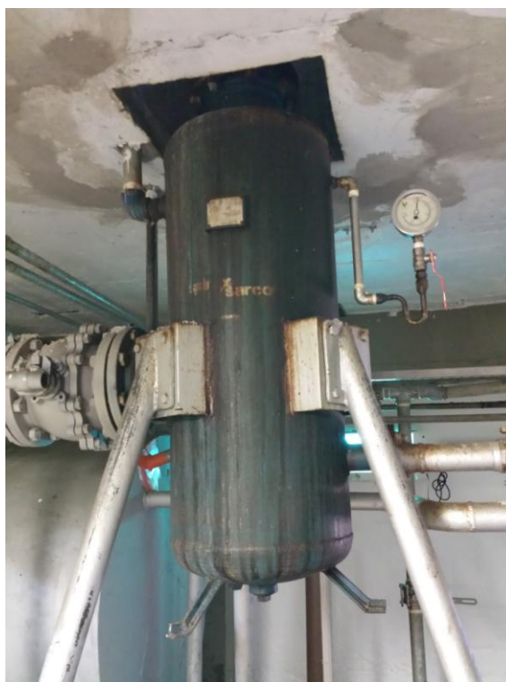
Tanque de reevaporação instalado. Fonte: Produção do próprio autor.
