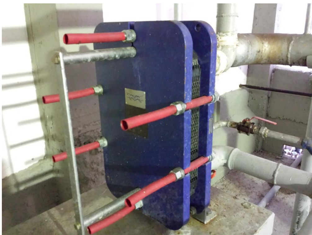
Trocador de Calor instalado. Fonte: Produção do próprio autor.
