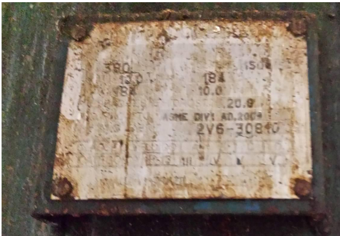
Placa de identificação do tanque de reevaporação instalado. Fonte: Produção do próprio autor.
