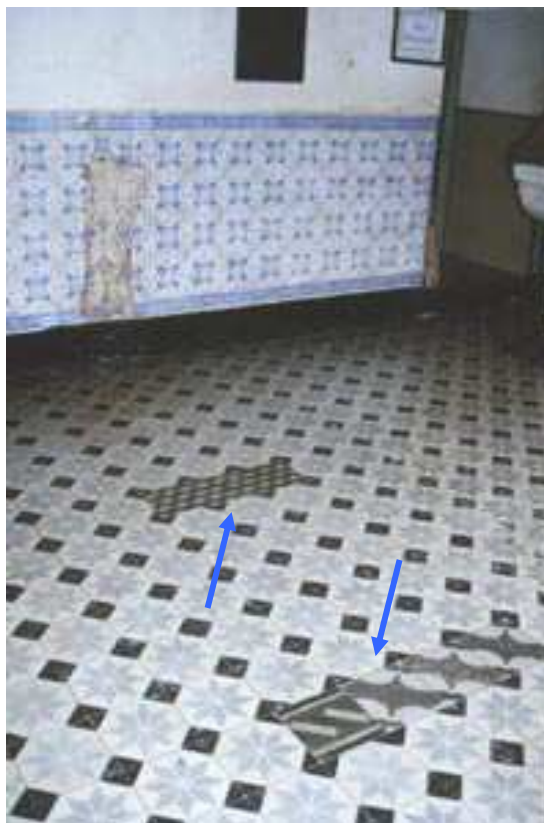
Figura 37 – Intervenção desastrosa: as peças de ladrilhos hidráulicos quebradas foram repostas por peças de desenho e estilo diferentes, formando uma colcha de retalhos com mais de 20 tipos diferentes de ladrilhos. ( http://www.sergioprata.com.br ).
