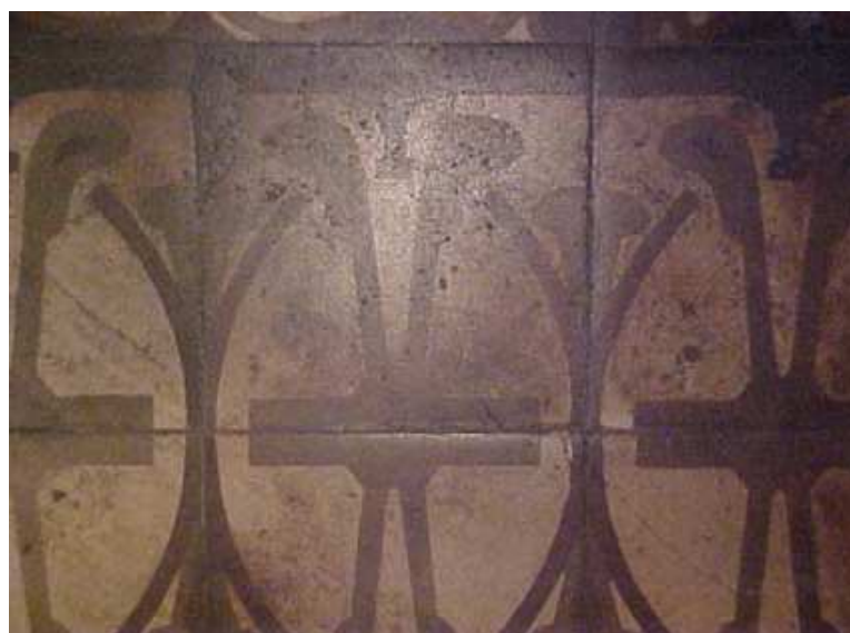
Figuras 27 e 28 – Manchas de oxidação por peças de aço. (DA GUIA, MEDEIROS, DE SOUZA, 2002).
