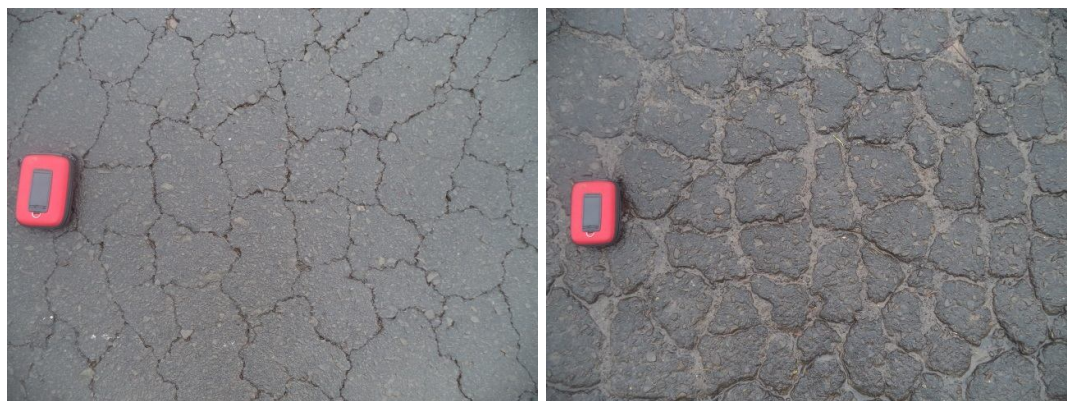
Figura 2.10 – Trincas no revestimento asfáltico de uma via urbana de Santa Maria
