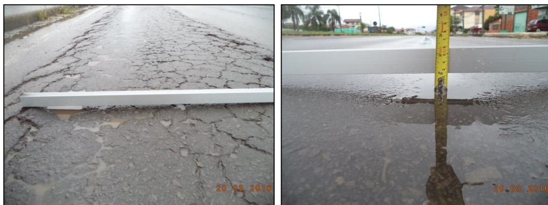
Figura 2.4 – Afundamento na trilha de roda por consolidação (ATC) na RS 509
