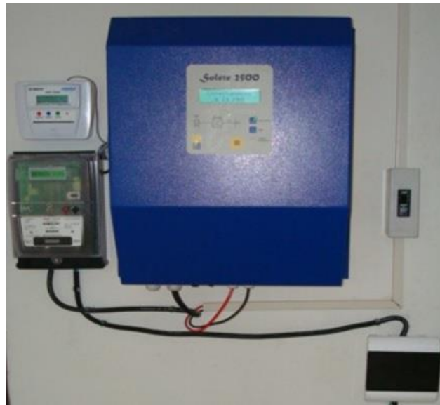
Figura 9 - Inversor componente de um sistema interligado à rede
