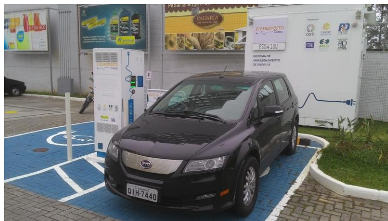
Figura 4.3 – Estação de recarga (carregamento rápido) instalada no posto Ilha Bela em Florianópolis.
