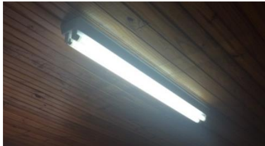
Figura 6 – Lâmpadas tubulares fluorescentes encontradas em algumas salas.
