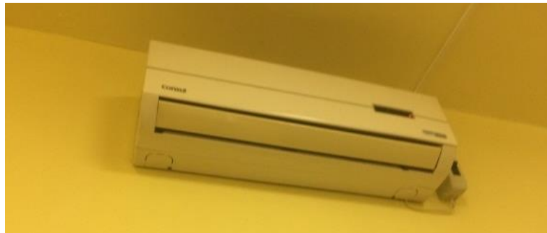
Figura 9 – Ar Condicionado Split.
