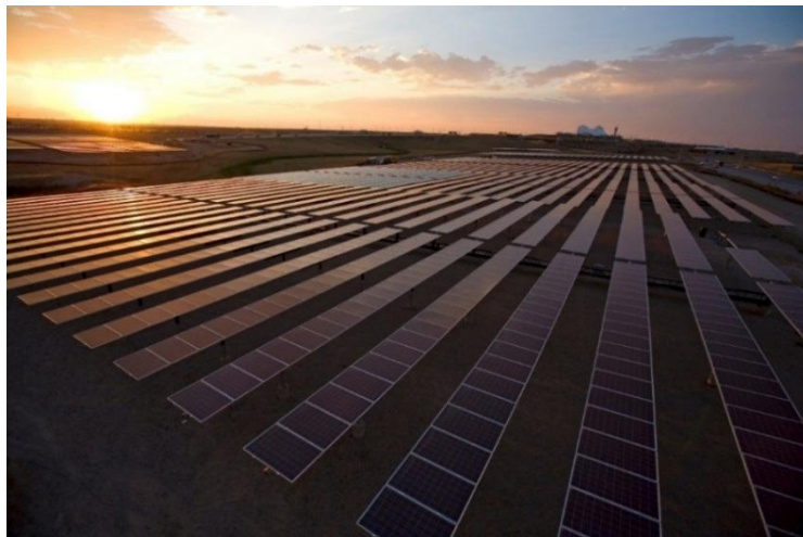
Figura 21 – Painéis instalados no Aeroporto Internacional de Denver , nos Estados Unidos
