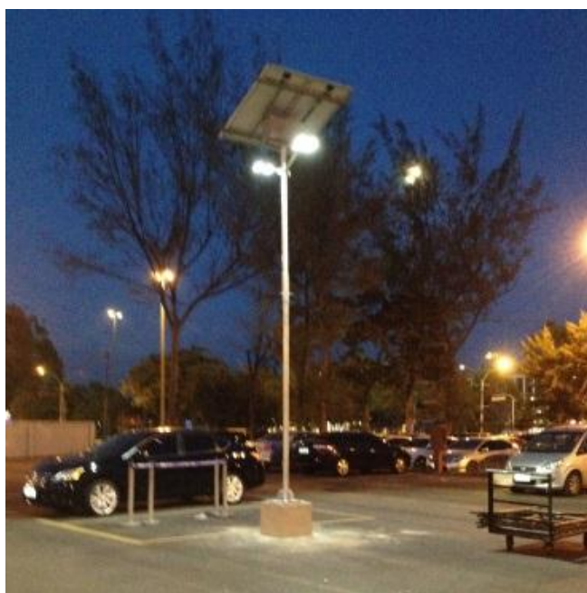
Figura 17 – Poste autônomo de energia no estacionamento do Aeroporto Santos Dumont
