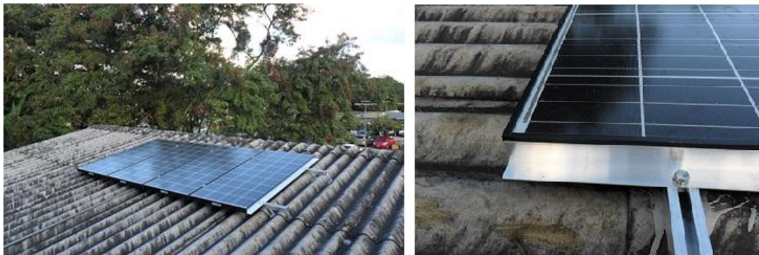
Figura 13 – Sistema fotovoltaico piloto instalado em cobertura no Aeroporto de Jacarepaguá no Rio de Janeiro
