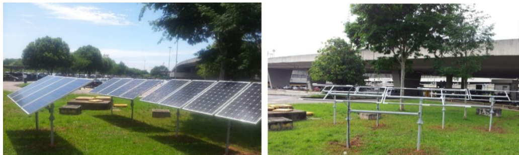
Figura 14 – Sistema fotovoltaico piloto instalado no solo no Aeroporto do Galeão – RJ
