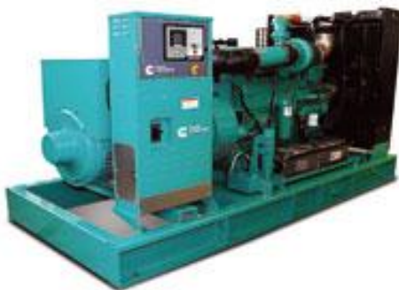
Figura 1.1 – grupo motor gerador a diesel
