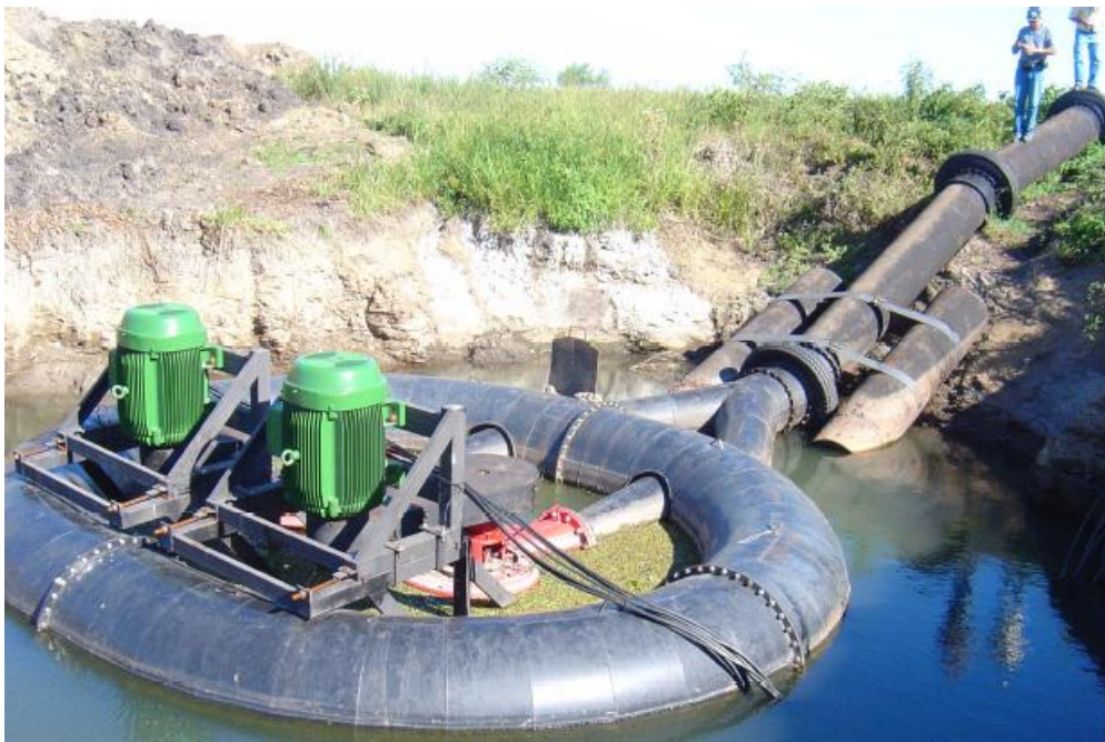
Figura 2.5 – Bombas de levante instaladas em flutuador
