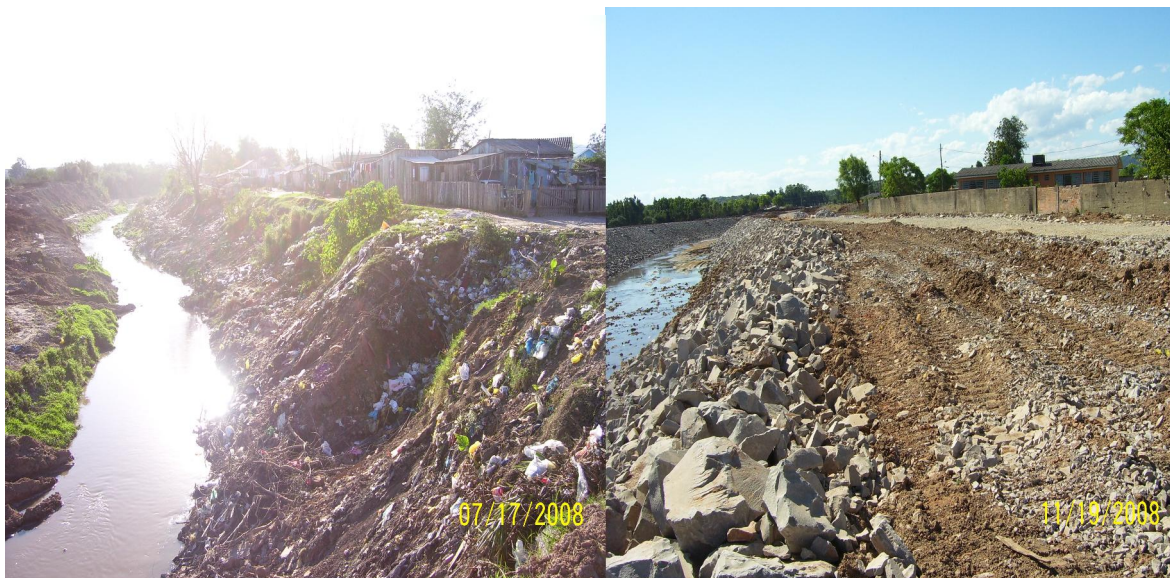
Figura A3: Antes de Retirada das Casas da Área de Risco na Vila Lúcia.
