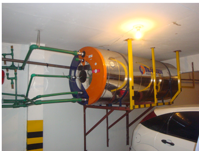
Figura 9 – Reservatório de água quente inferior 1500 litros.
