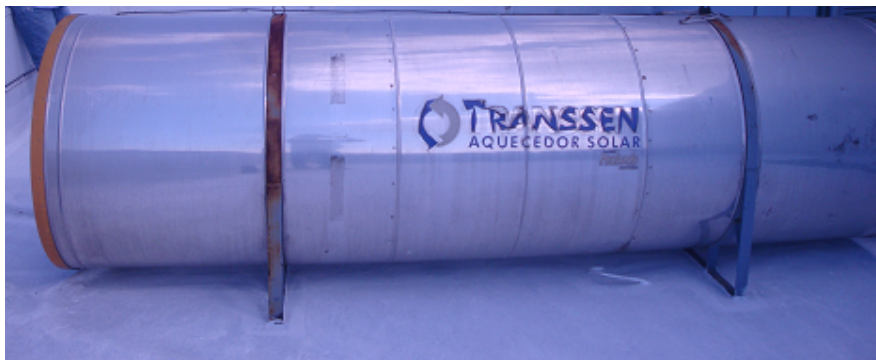
Figura 10 – Reservatório de água quente superior 2000 litros.
