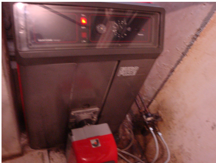
Figura 8 – Gerador de calor a óleo diesel.
