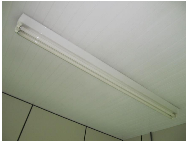
Figura 17 – Luminária sem fechamento lateral
