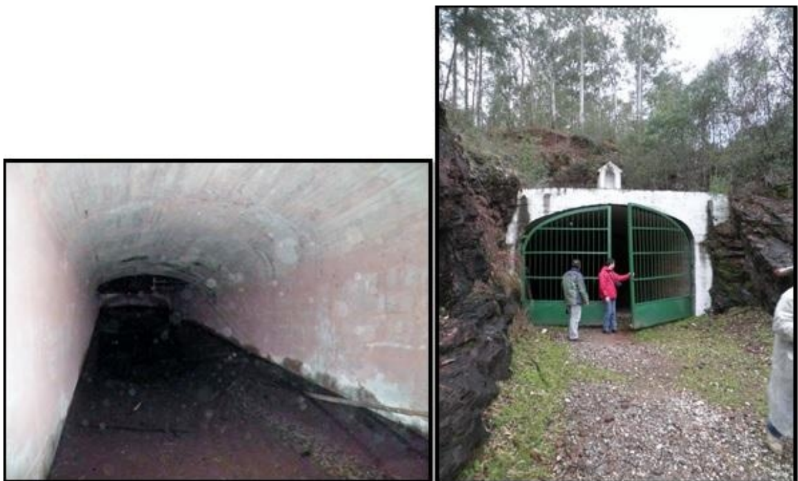
Figura 05 – Vista interna e externa de uma das galerias que se encontra alagada. Fonte: acervo da autora.
