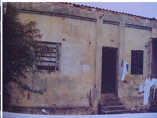
Foto 20 – Fachada posterior, já com alterações das esquadrias.
