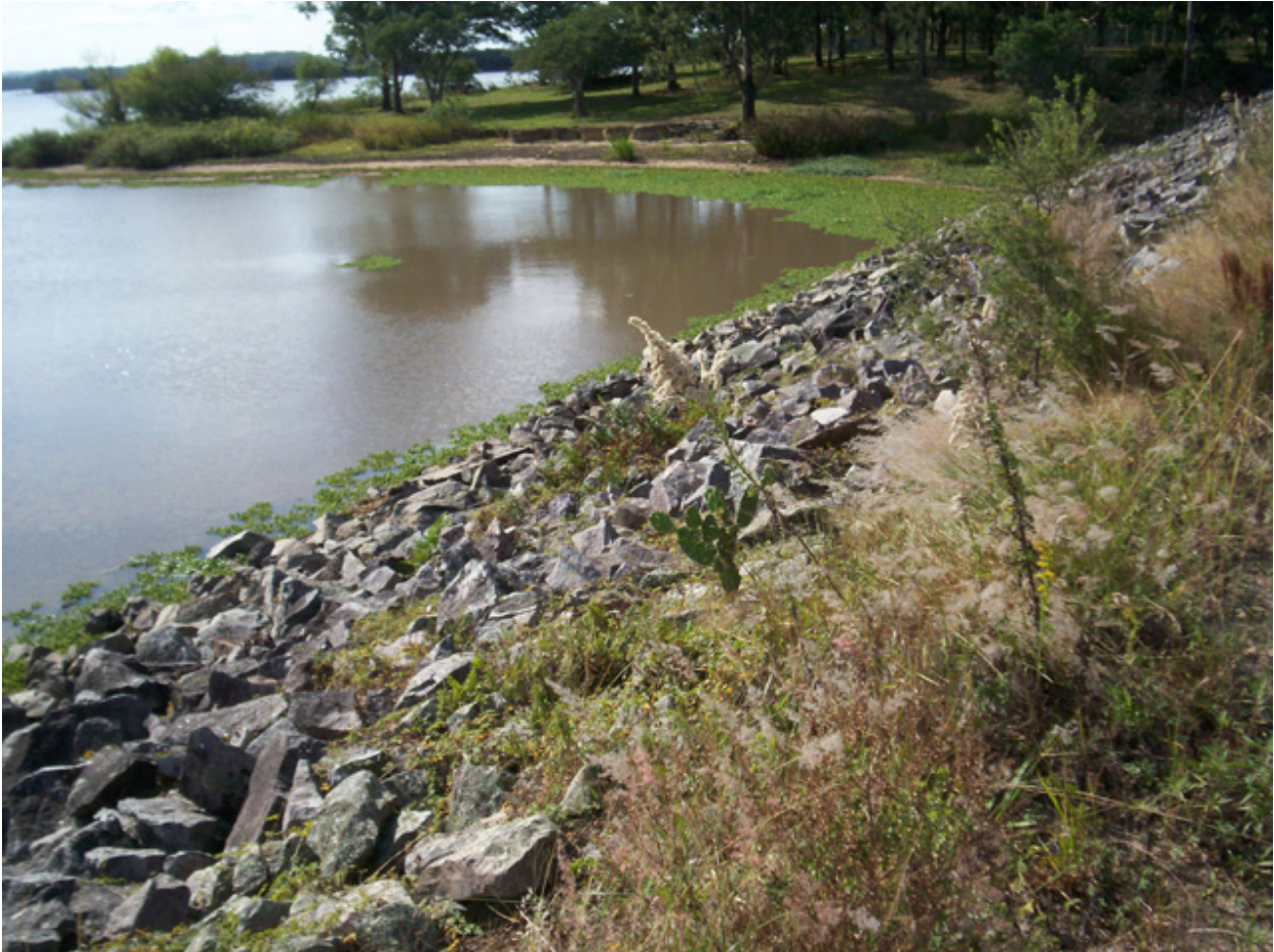
FIGURA 3.6 – Exemplo de reservatório como problemas relacionados a turbidez e desenvolvimento de macrófitas. Imagem: Adroaldo Dias Robaina e Marcia Xavier Peiter
