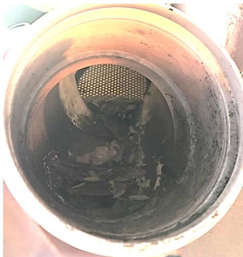
Figura 13 – Materiais e partículas retidas no filtro instalado no sistema
