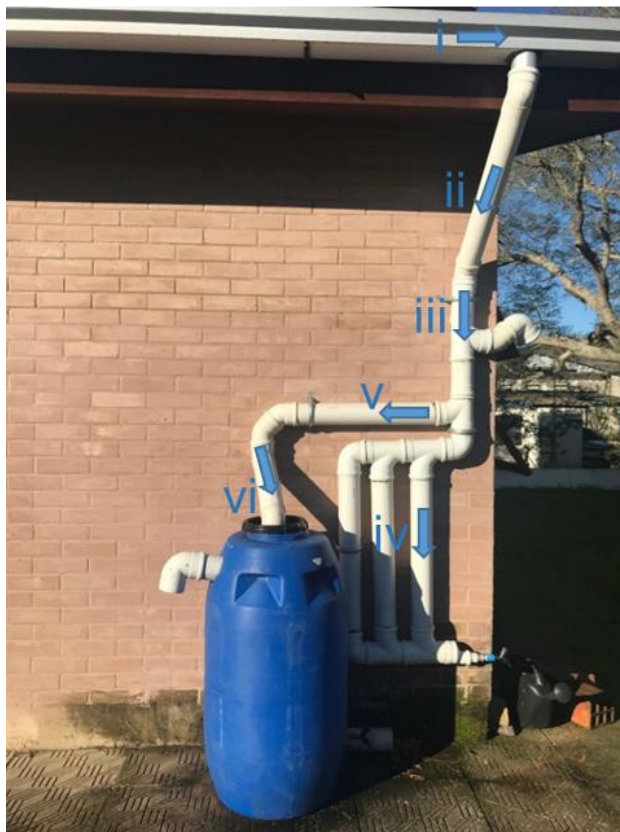
Figura 8 - Modelo experimental coleta de águas pluviais: filtro, dispositivo de descarte para 2 mm da precipitação e reservatório de armazenamento com capacidade de 200L.
