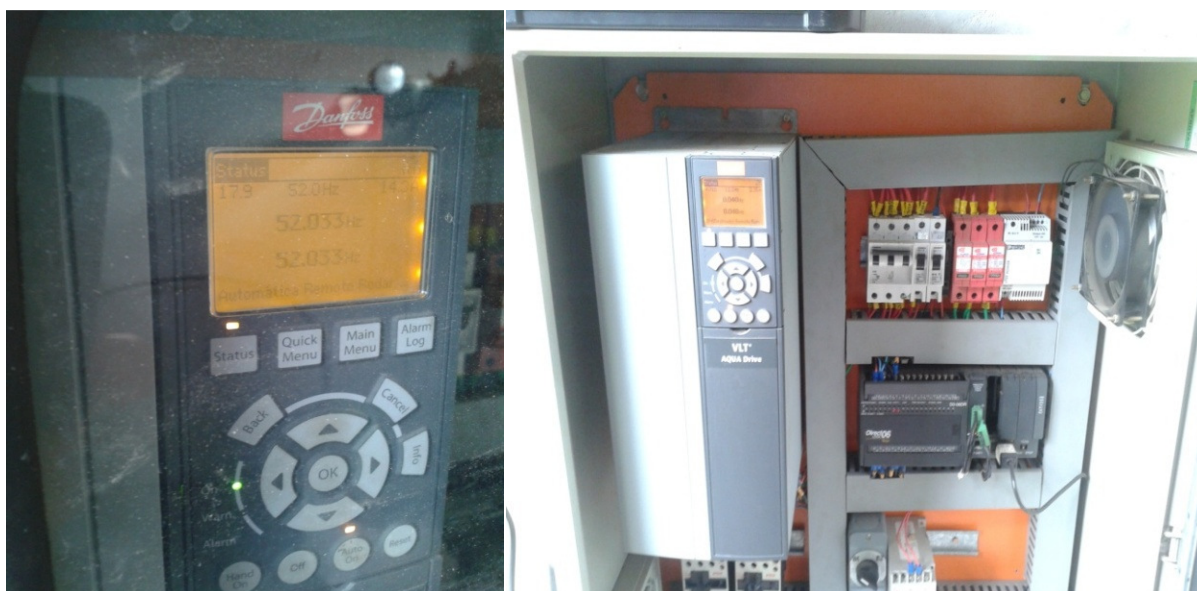
Figura 9 – Inversor e quadro de automação
