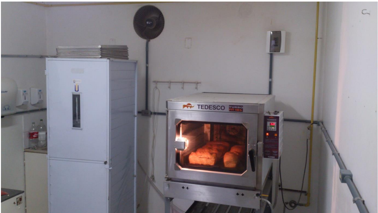
Figura 53 – Padaria e forno elétrico Fonte: Autor do trabalho (2015).
