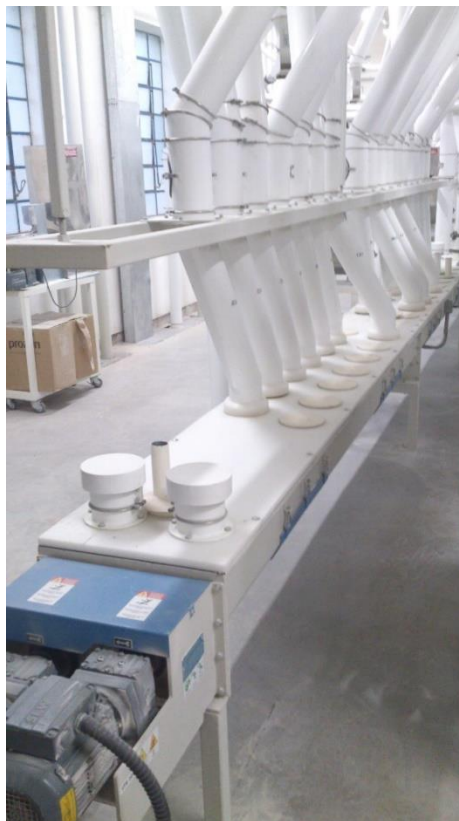
Figura 16 – Rosca dosadora de aditivos químicos Fonte: Autor do trabalho (2015).
