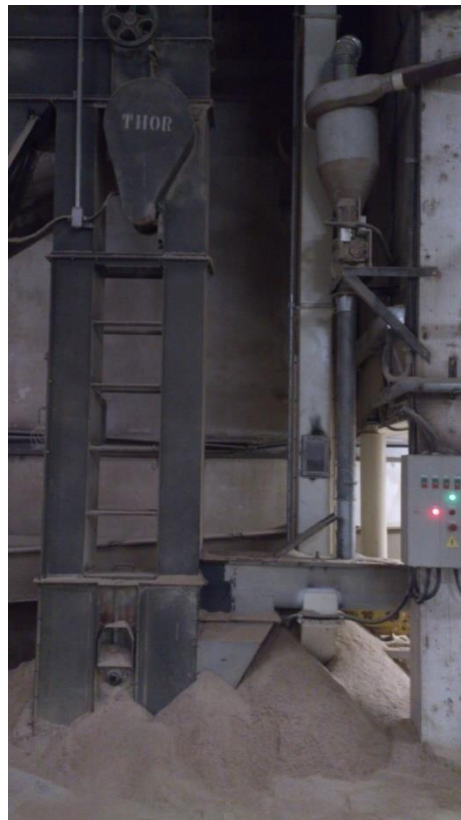
Figura 44 – Elevador de carga para expedição de farelo a granel Fonte: Autor do trabalho (2015).
