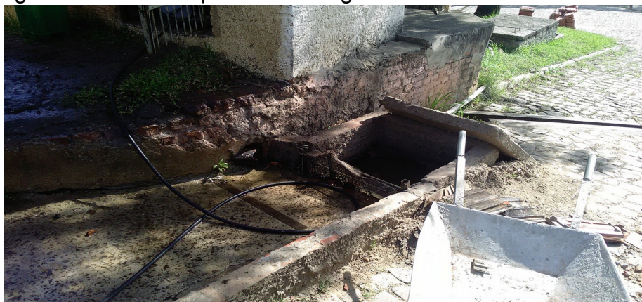
Figura 4 – Caixa Separadora de água e óleo
