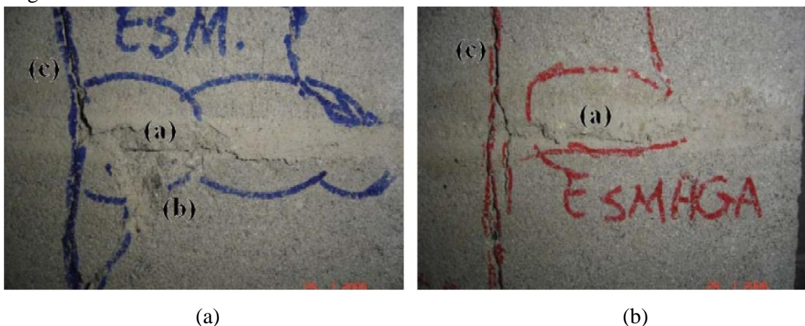
Figura 8 – Mecanismo de ruptura dos prismas ensaiados: (a) junta de argamassa forte; (b) junta de argamassa fraca.
