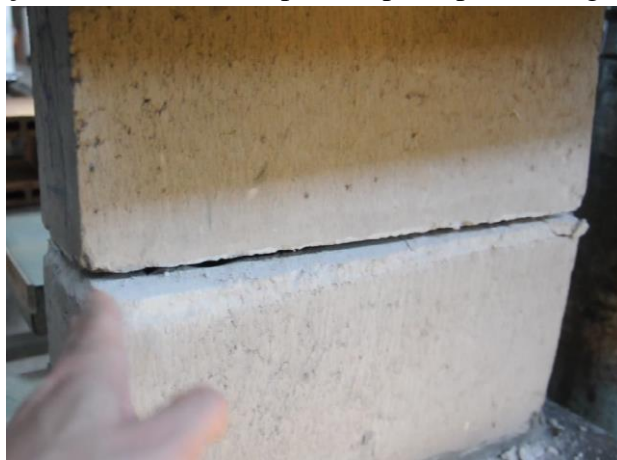
Figura 47 – Quebra da ligação entre os blocos, após a ruptura pelo esmagamento da junta.
