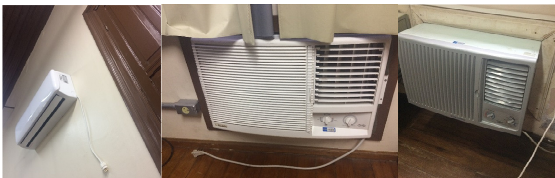
Figura 64 - Aparelhos condicionadores de ar instalados no Palacete Dr. Astrogildo de Azevedo.
