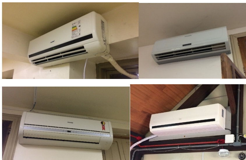
Figura 55 - Aparelhos condicionadores de ar do tipo Split, instalados no Colégio Manoel Ribas.
