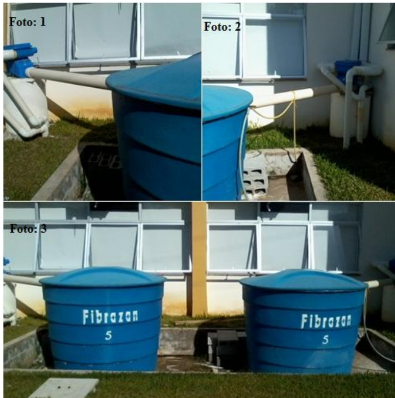
Figura 12: Reservatórios para água da chuva situada no prédio 16 na UFSM.
