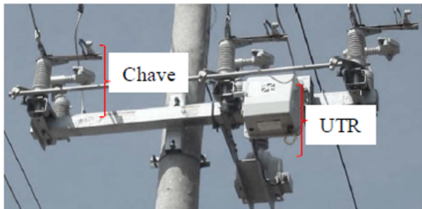
Figura 8 – Chave trabalhando em conjunto com a UTR.
