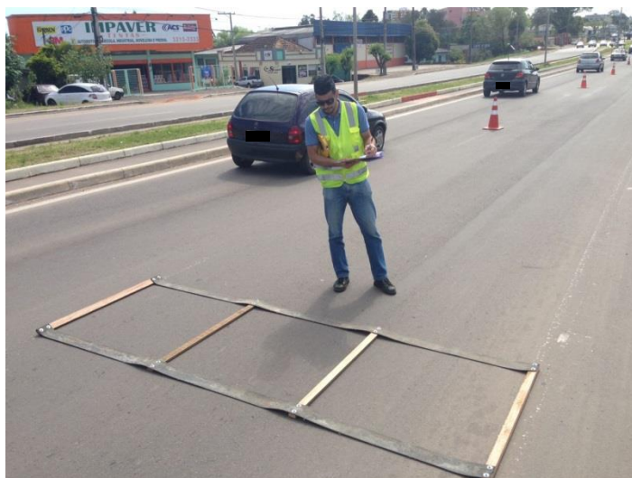
Figura 3.23 – Execução do levantamento de área trincada
