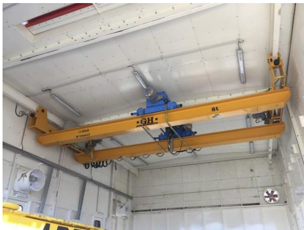
Figura 3 - Ponte rolante suspensa bi viga
