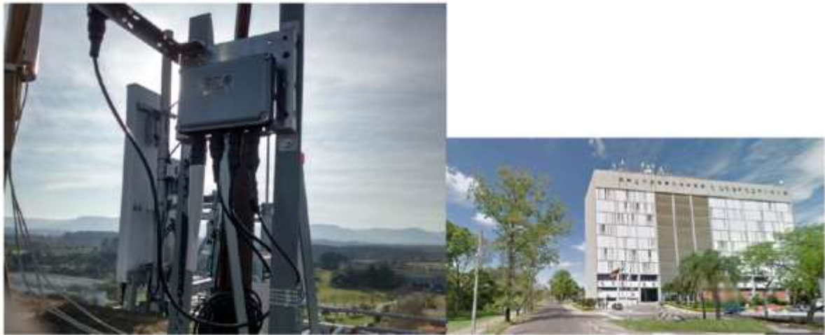
Figura 31 – Concentrador LoRaWAN instalado na UFSM (Campus Camobi) (à esquerda), no lado no prédio da reitoria (à direita).
