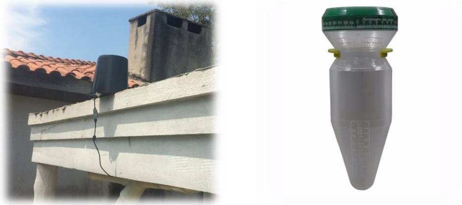
Figura 13 - Pluviógrafo e pluviômetros instalados sobre os telhados.
